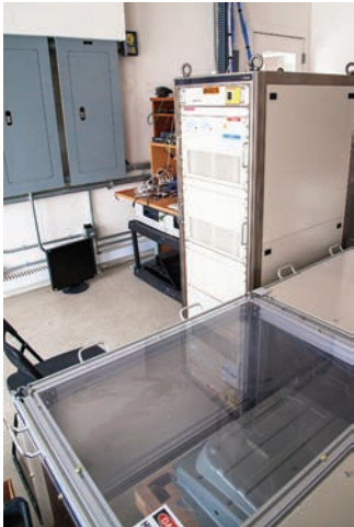
スマートハウス内に設置されたバッテリー
